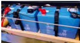
上記写真は、Ultra Power 4800 (Victron Energy)の電装類になります。
